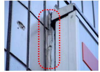
コーキングが劣化した状態
