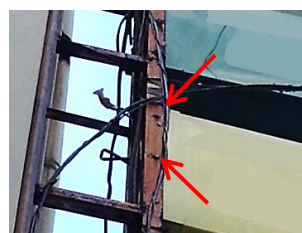
ボルトのゆるみや欠落した状態
