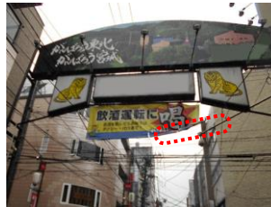
幕材を張る部材が破損した 状態
