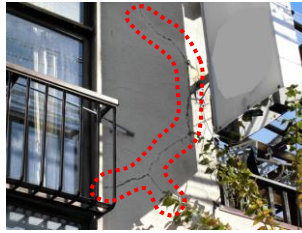
壁面にひびが生じた状態
