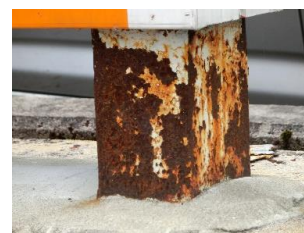
支柱根元の腐食が進行した状態
