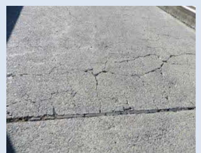
舗装のひびわれ
