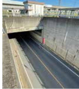
令和に入り5台水没事故が発生している宿地下道
