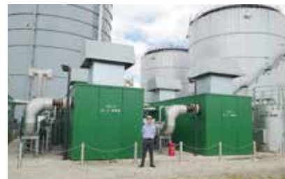
中川水循環センター（三郷市の汚泥消化施設）
