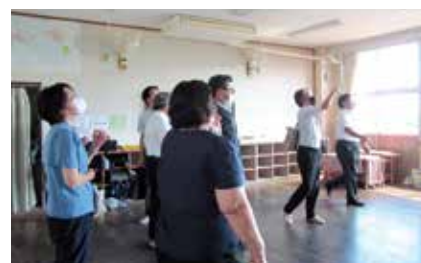
「本町小で雨漏り箇所を確認」
