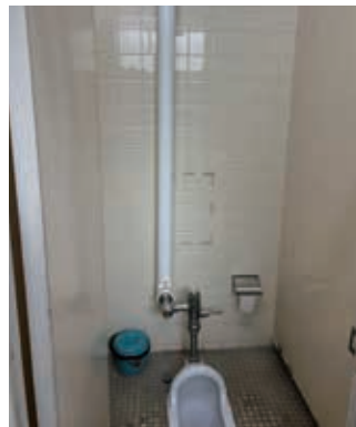
体育館の手すりもない和式トイレ
