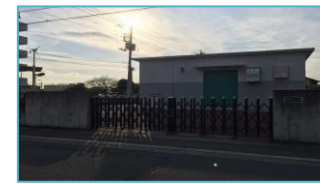
西大輪中継ポンプ場
