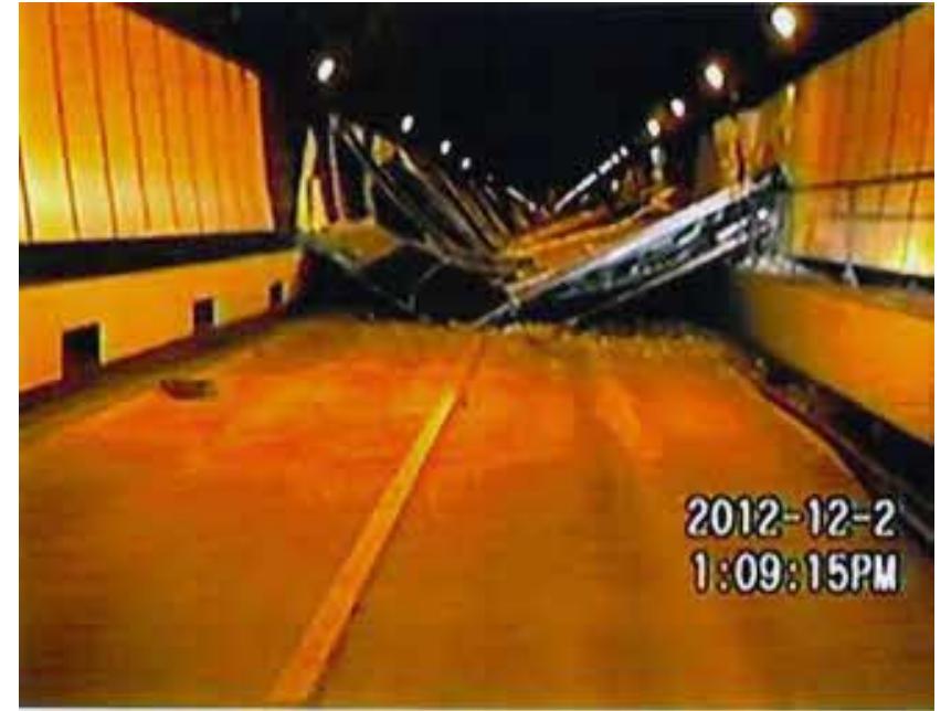
【山梨県】中央道笹子トンネル崩落事故（平成24年）
