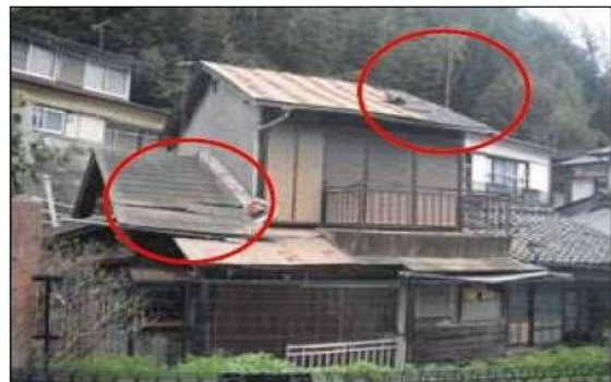
アスファルト屋根等の一部にズレがあり、雨漏りのある例（評価点15点）
