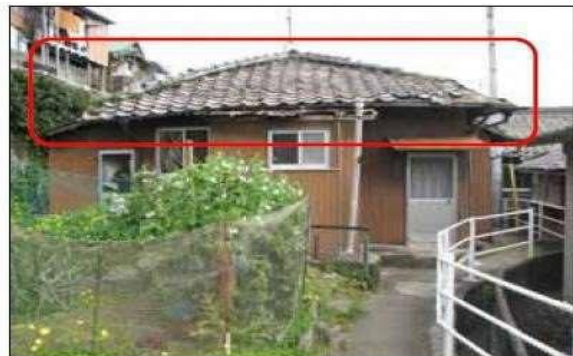
屋根に不陸（凹凸）がある例（評価点50点）
