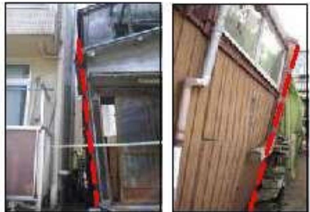
柱の変形が著しく崩壊の危険がある例（100点）
