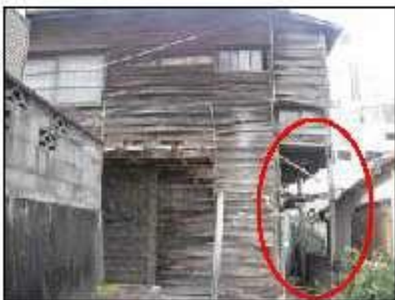
柱の数ヶ所に破損がある例（50点）
