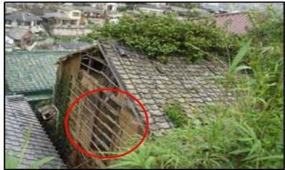
外壁が剥落し、著しく下地が露出するとともに、壁体を貫通する穴を生じている例（評価点25点）
