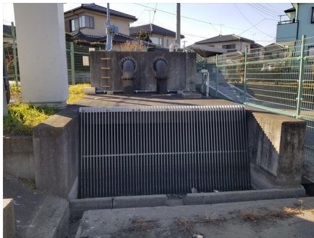
鷺宮5丁目地区排水ポンプ施設
