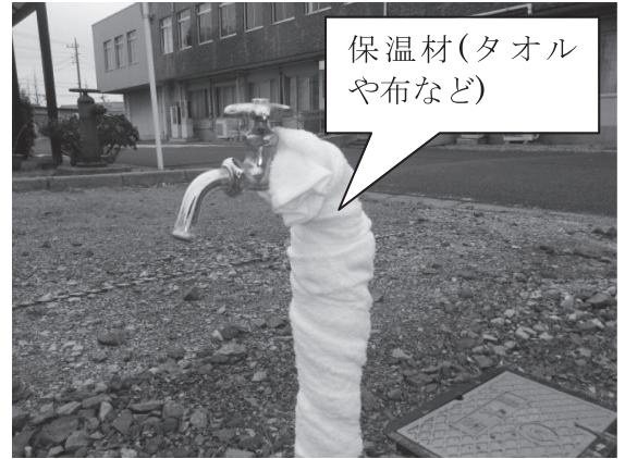
(水道管に布を巻いて応急処置をした状態)
