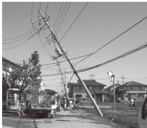
液状化により傾いた電柱（南栗橋地域）
