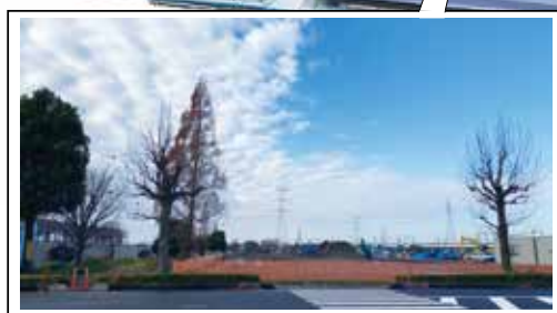
★印から撮影した現地の現況。既に工事が始まっています。(12月9日撮影)
