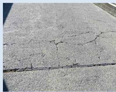
舗装のひびわれ
